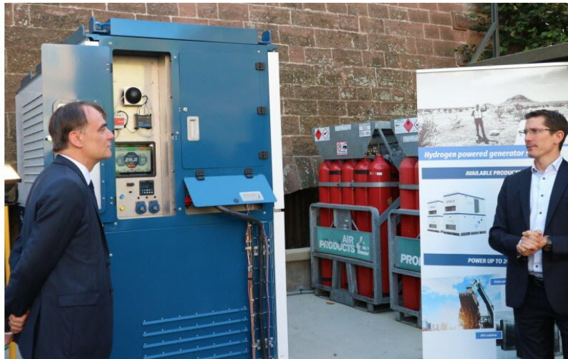
Le générateur hydrogène Thytan installé à la préfecture de Belfort en présence du préfet, Raphaël Sodini (à gauche) et de Sébastien Faivre, président de H2SYS. Photo DR
